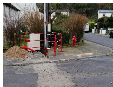
Enfouissement des réseaux électriques et télécom rue des Bleuets Réalisés et pris en charge par le SIEGE27 pour 125 004 € TTC. La commune a financé pour 32 989 € TTC.
